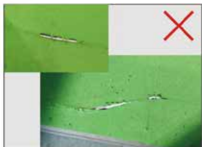
展位地面线路未使用线槽：不合格
