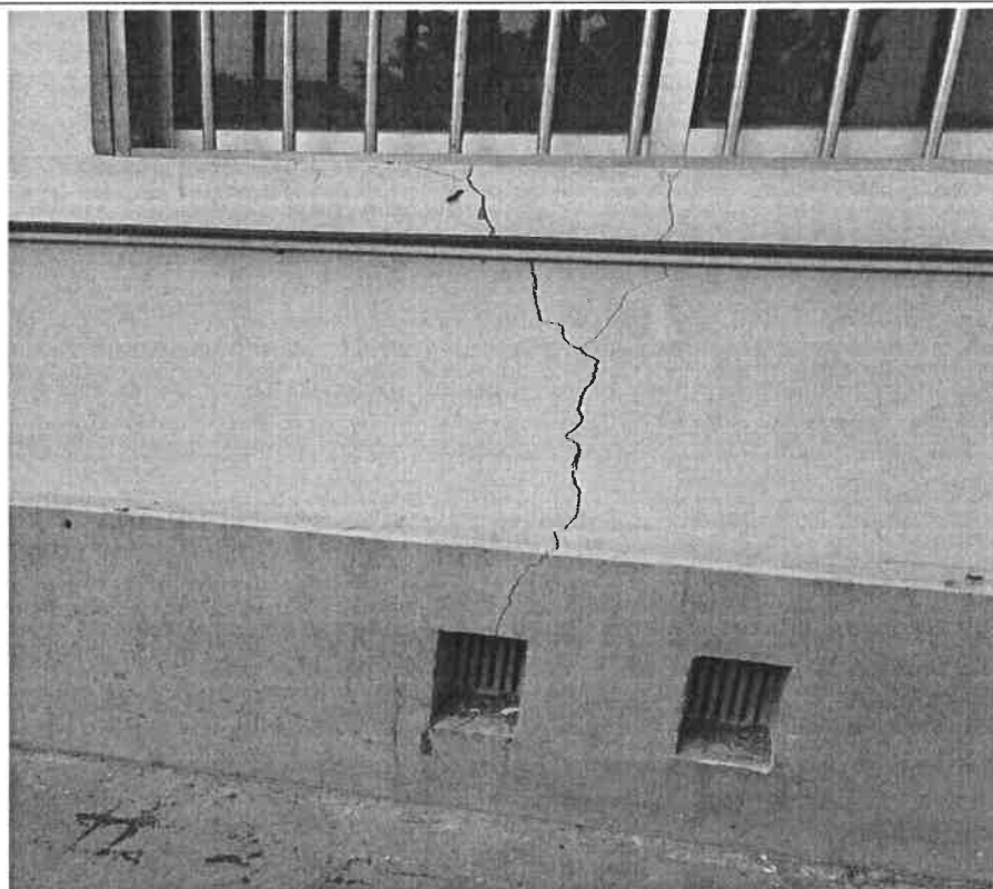
照片 9: 2×C~D 轴墙体开裂
