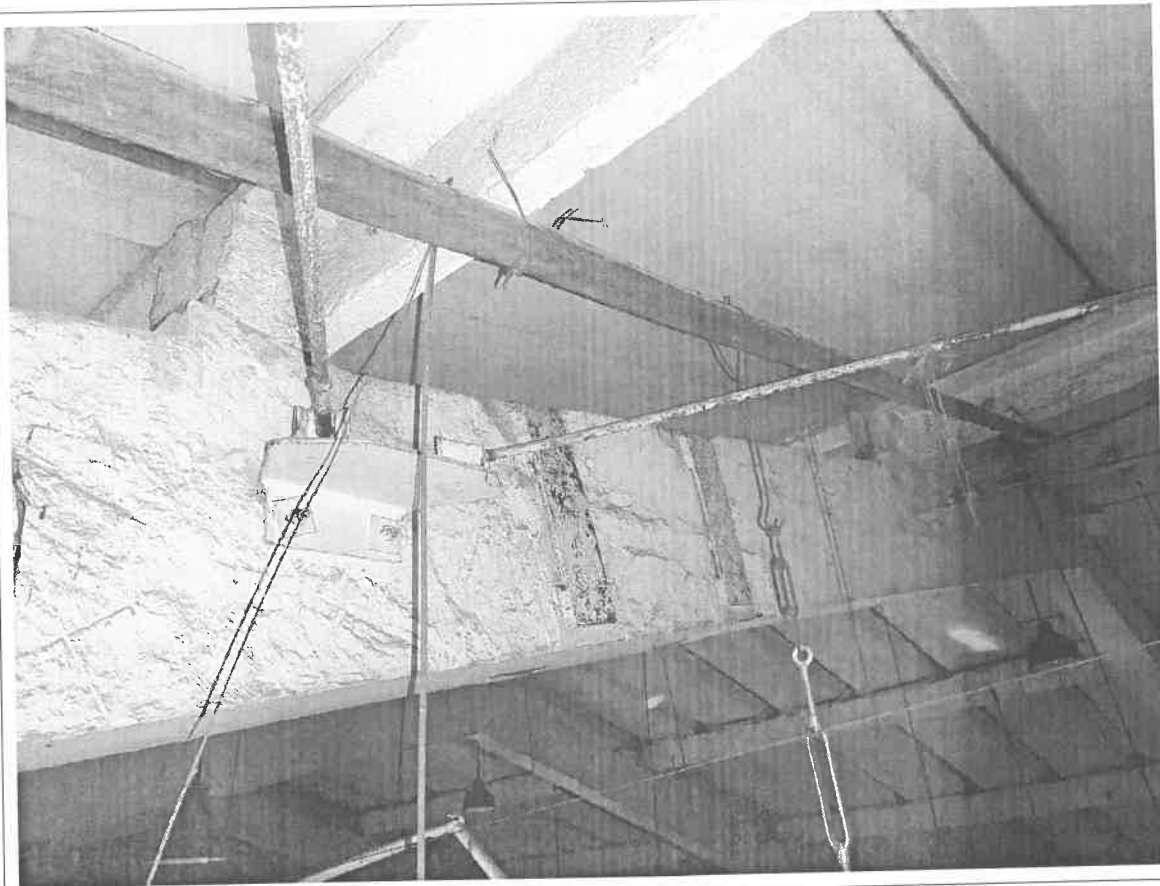
照片 9: 门架连接缀板、水平支撑锈蚀
