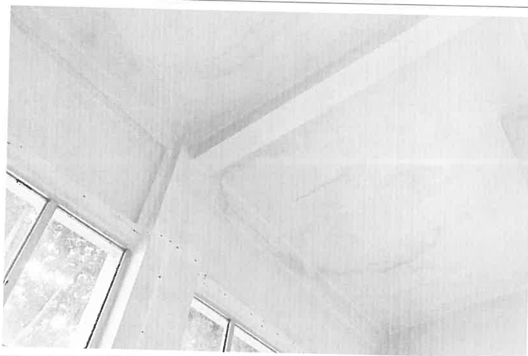
照片 8: 门廊屋面板开裂、渗水
