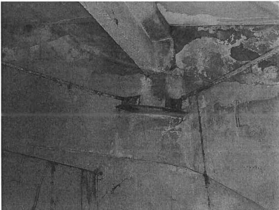
照片 14: 门架水平支撑锈蚀、屋面渗水
