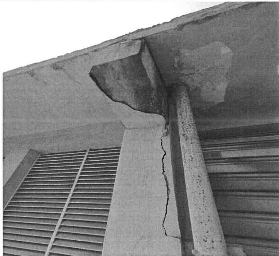
照片 6: 2×J 轴门架柱砂浆开裂、脱落
