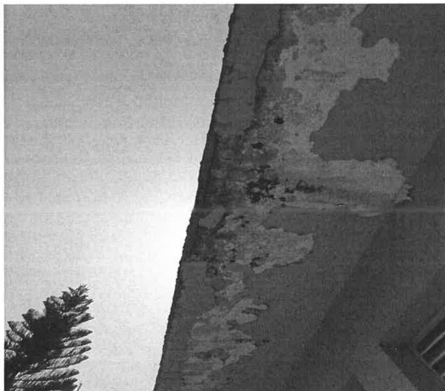
照片 8: 2-1000mm~2×F~G 轴现浇板开裂、钢筋锈蚀
