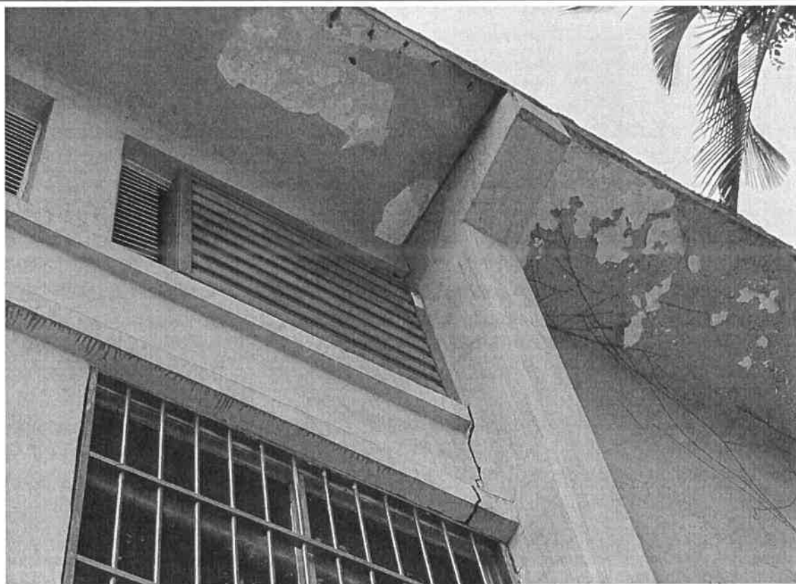
照片 10: 2×C 轴梁柱连接节点处开裂
