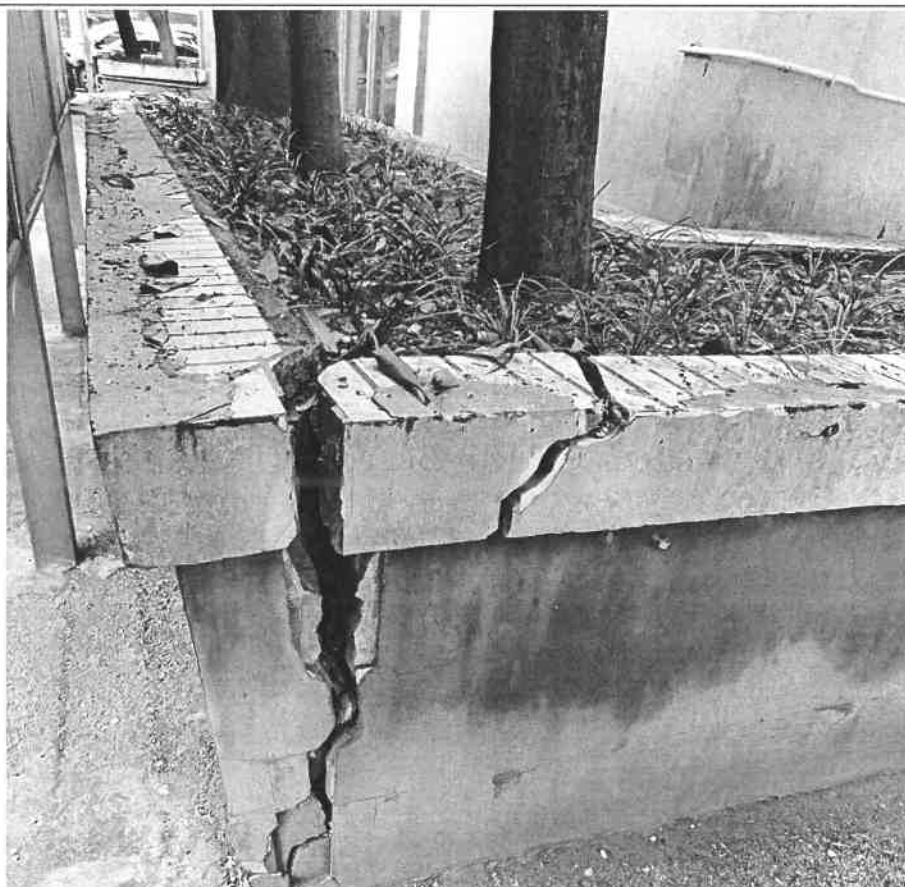
照片 16: 综合馆苗圃挡墙开裂
