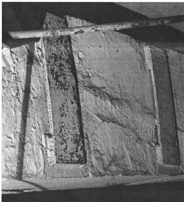
照片 15: 门架柱与梁连接缀板锈蚀
