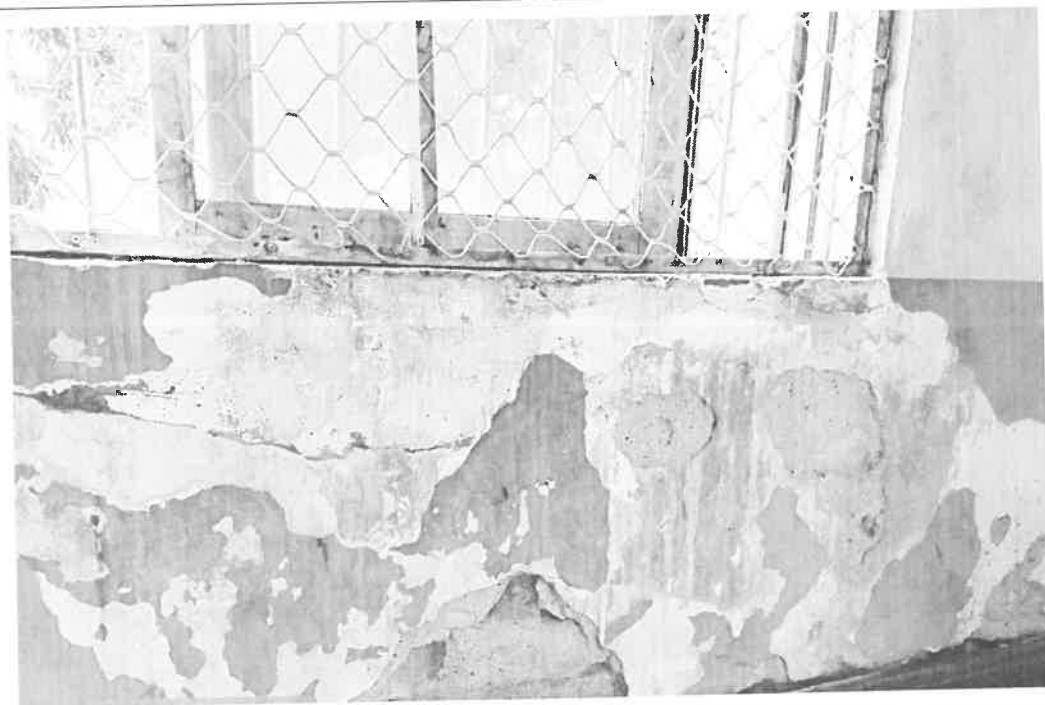
照片 10: 室内批灰风化脱落
